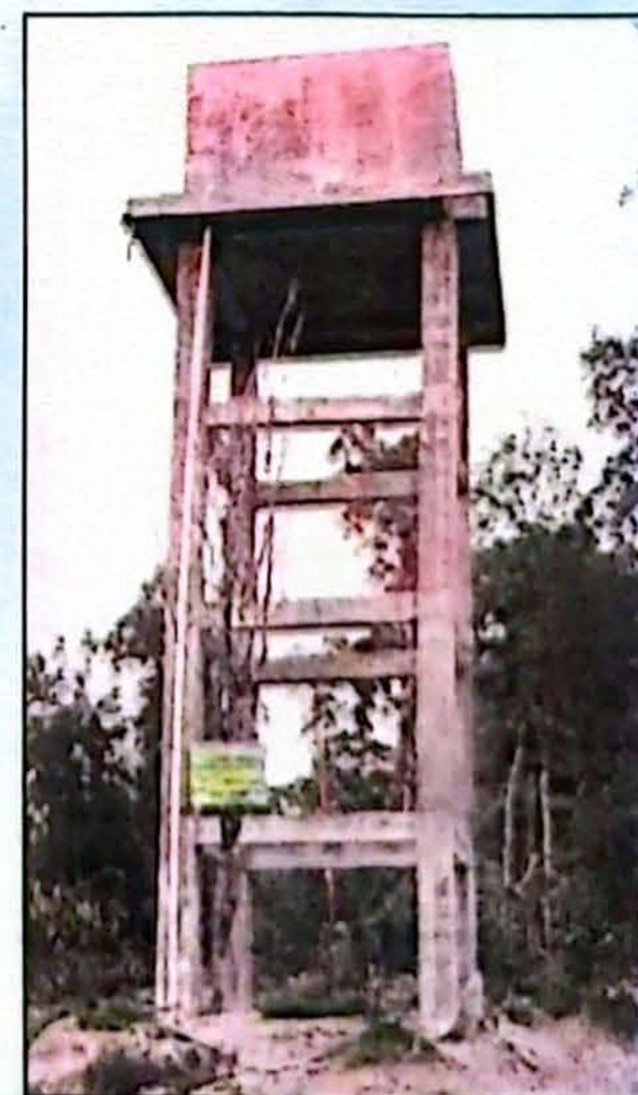
Tanque de almacenamiento de agua en Boca de Raspadura
