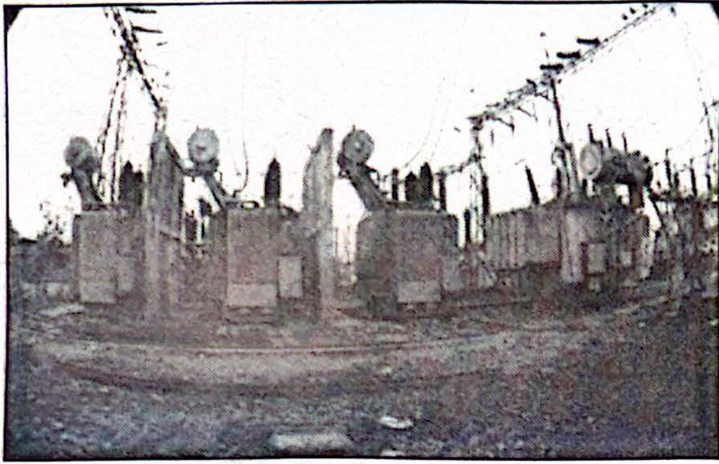
Sub-estación de Quibdó (foto archivo)
