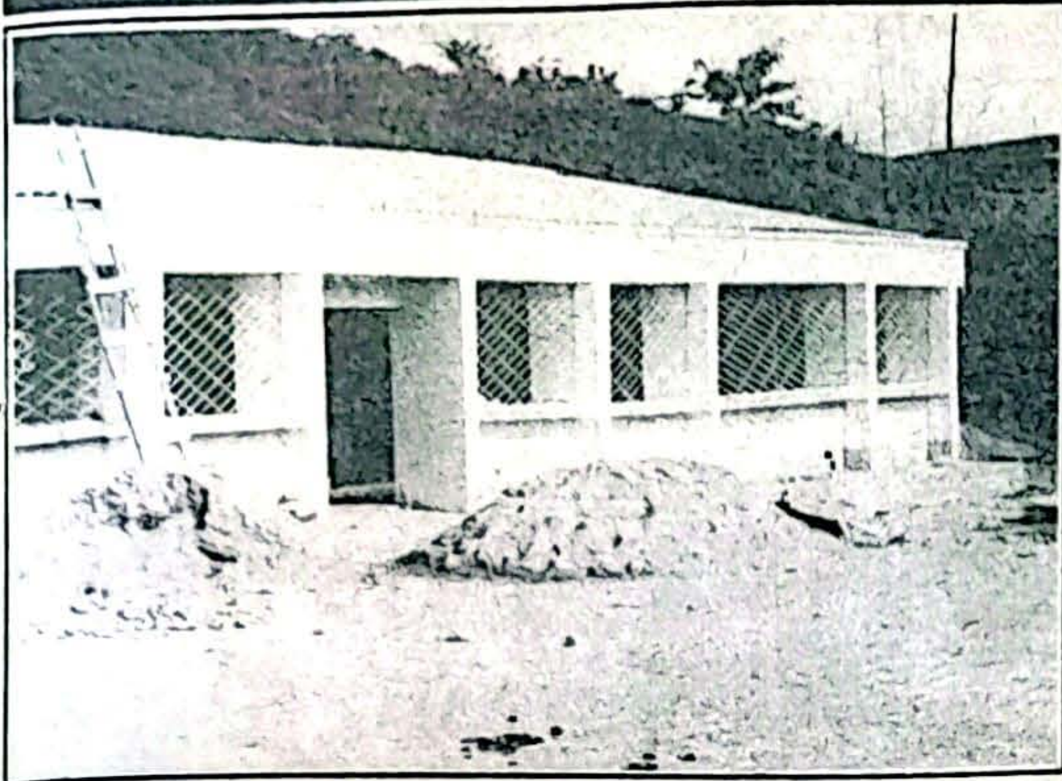
Construcción de aulas en la Escuela Normal Demetrio Salazar Castillo y apoyo a proceso educativo.
