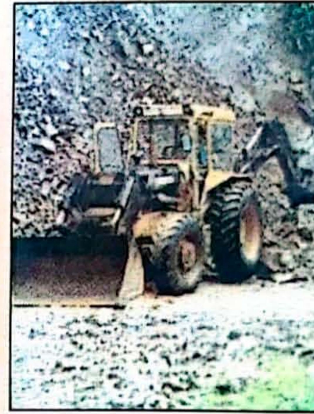
Atención de derrumbes
