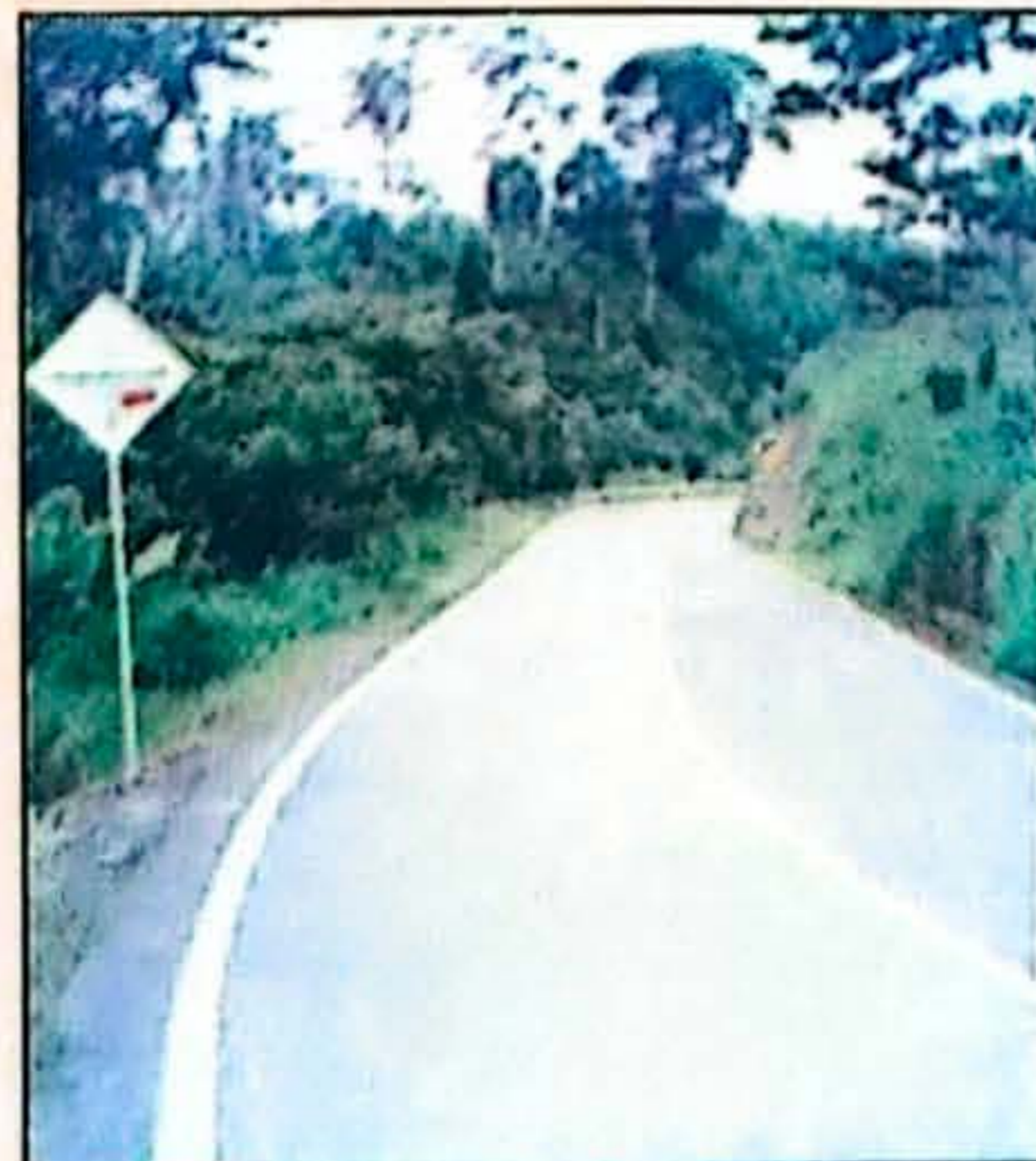
Construcción y pavimentación de la carretera Quibdó - La Mansa. Sector: Aguaclara - Tutunendo
