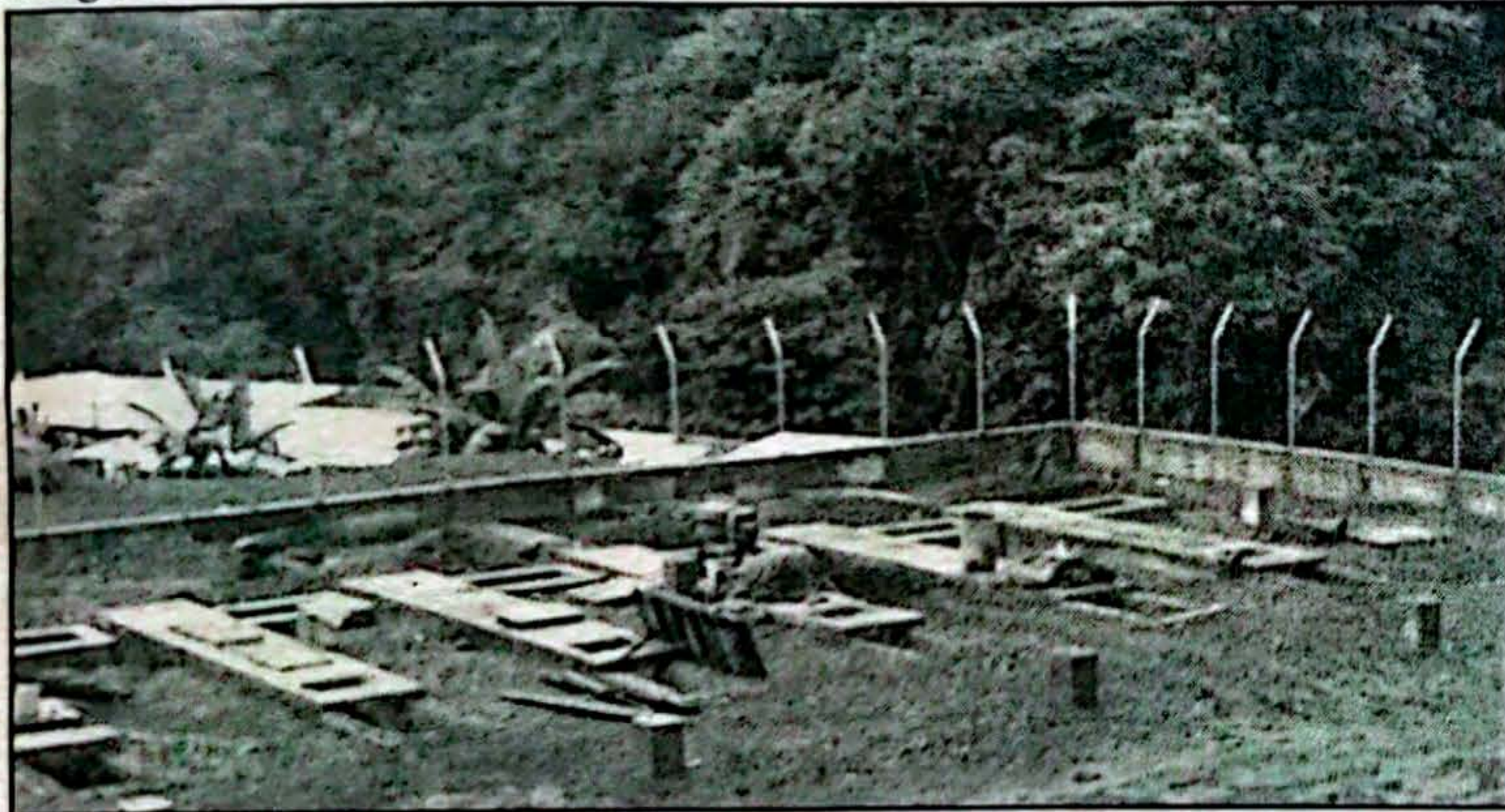
Casa de máquinas donde se instalarán los generadores de energía, cuya potencias generaran las aguas conducidas a través de grandes tubos
